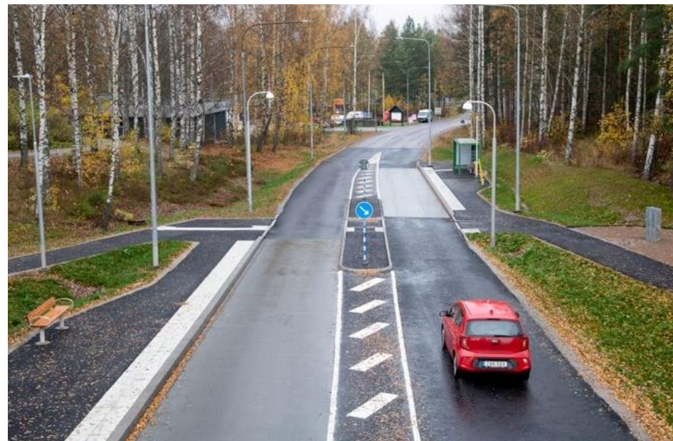
Figur 6 Den ombyggda hållplatsen Björkrivägen med förbättrade gångvägar och en ny gångpassage över Saxons väg. Foto: Fredrik Kellén
